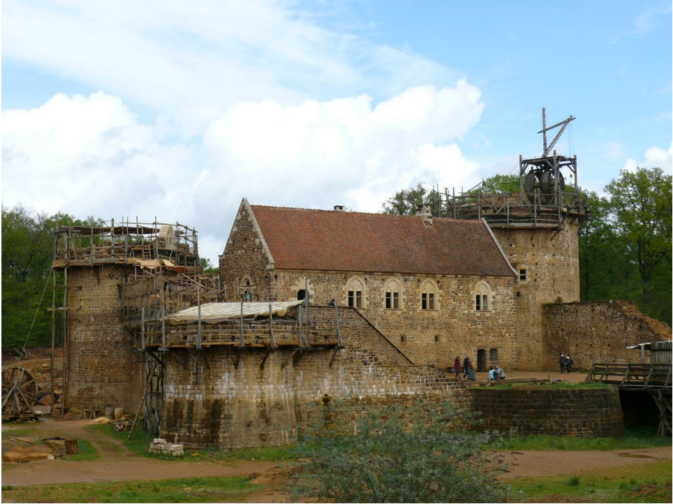
Figura 4. Um castelo do século XIII em construção em Guédelon, centro da França.
